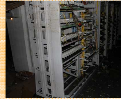
通信設備も浸水により大きく破損・損壊
