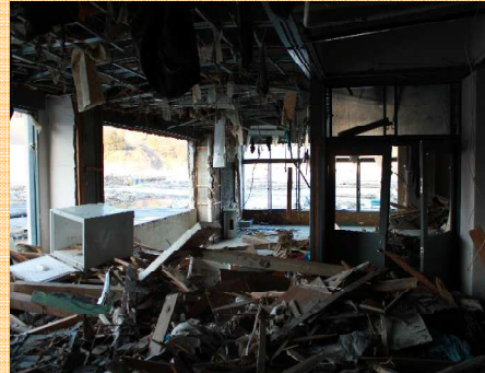
ビル壁が崩壊し内部にも大量の漂流物
